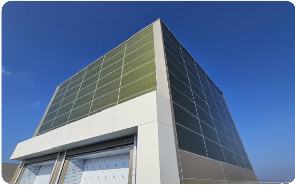
세종시 _ Solwall 10Kw
