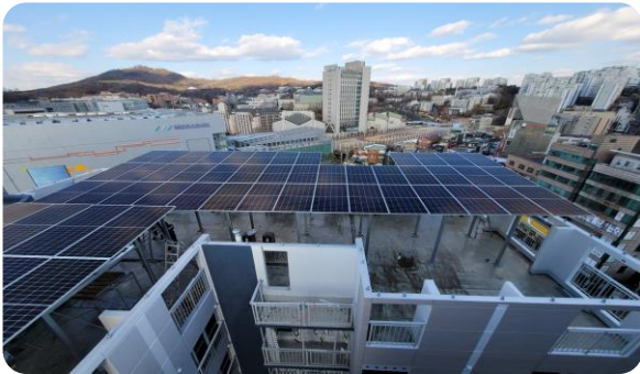
대현동 _ 옥상형태양광 20Kw
